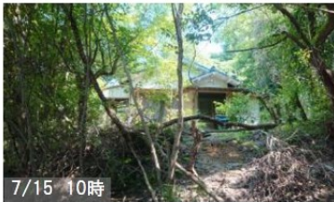
⑬土石流脇の家屋 土石流の痕跡から10mほどの 空き屋は無傷で残っていた
