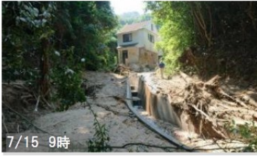
⑦被災したMさん宅 1階部分が一部損壊。宅内には 大量の土砂が流入した
