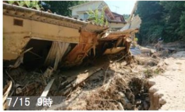
⑧被災した家屋 土石流の影響が一番受けた家 屋は倒壊している
